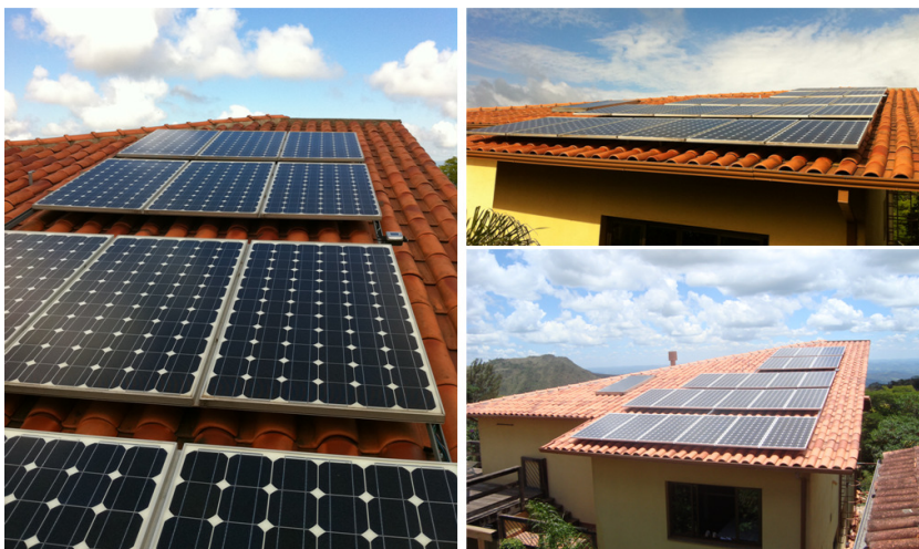
Figura 3.7 - BHO-1: SFVR residencial em Belo Horizonte - MG.
